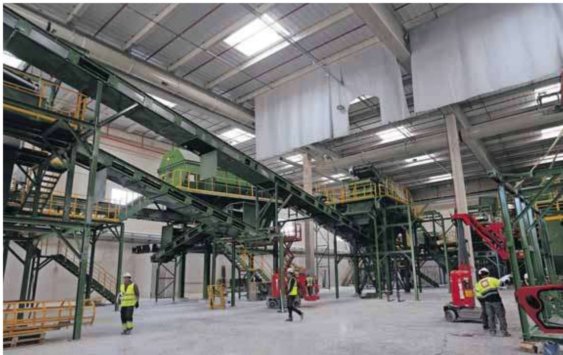
Parte de la maquinaria que se usará para el tratamiento de los residuos ya está instalada en uno de los edificios del centro. EDUARDO BUXENS
