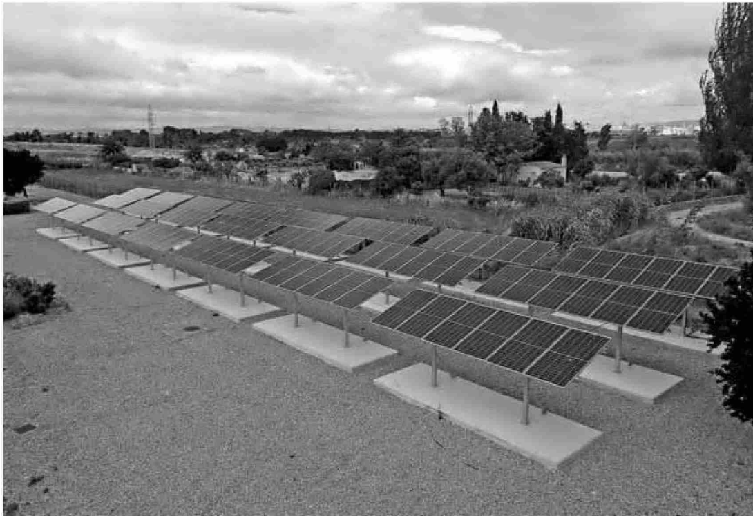
Placas solares en la depuradora de Tudela.
