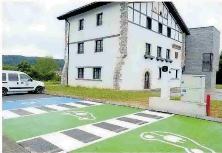
El punto de carga para vehículos eléctricos se ha instalado en el exterior del Ayuntamiento.
