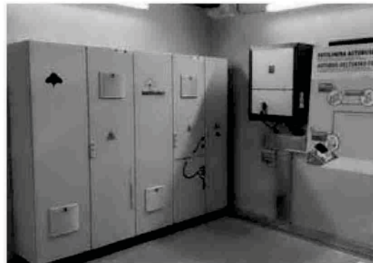
Instalación de 60 kWh en la estación de autobuses de Pamplona. CEDIDA
