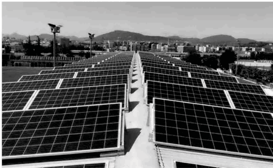
Paneles solares instalados en el colegio Luis Amigó.
