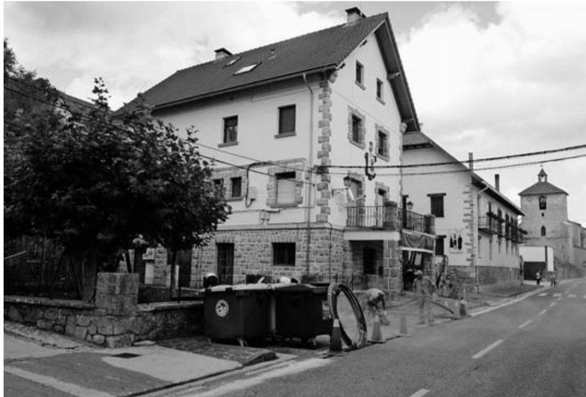
Obras de canalización de fibra óptica en Abaurrea Alta (Aezkoa) impulsadas por el Gobierno.
