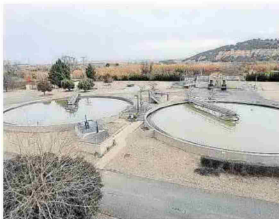
Imagen de depósitos en la actual depuradora.
