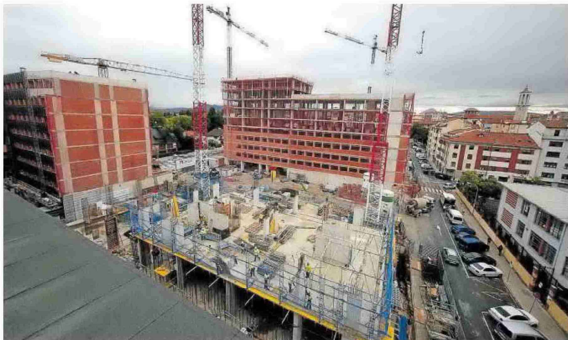
Obras de construcción de viviendas en el solar de Salesianos. Foto: Javier Bergasa
