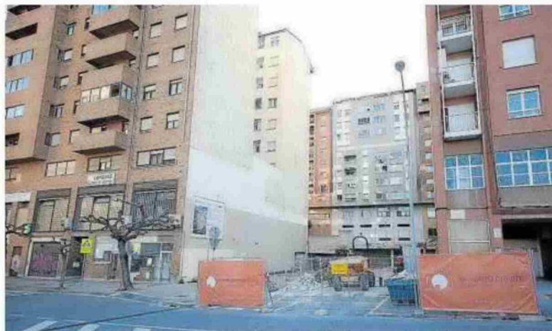
Las obras del edificio de Río Altzania ya han comenzado y tienen un plazo de 18 meses.
