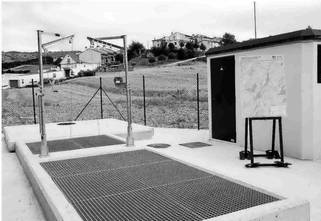
La estación de bombeo de aguas residuales, con algunas casas del pueblo de Legarda detrás. Fotos: Oskar Montero
