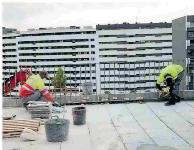
Obreros realizando trabajos de reparación en el mirador de la Ripa. Foto: Oskar Monteiro
