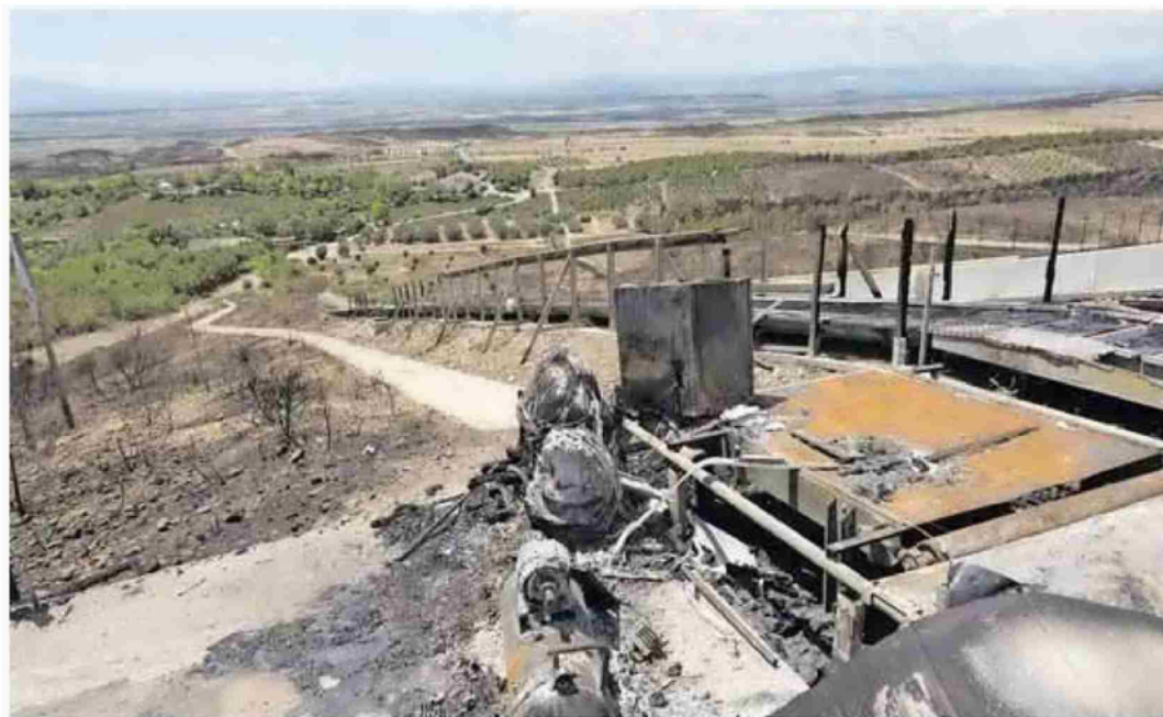
La salida y llegada del tubing del parque, destruida por el incendio de junio, y al fondo el resto del parque al que no llegaron las llamas. ARCHIVO
