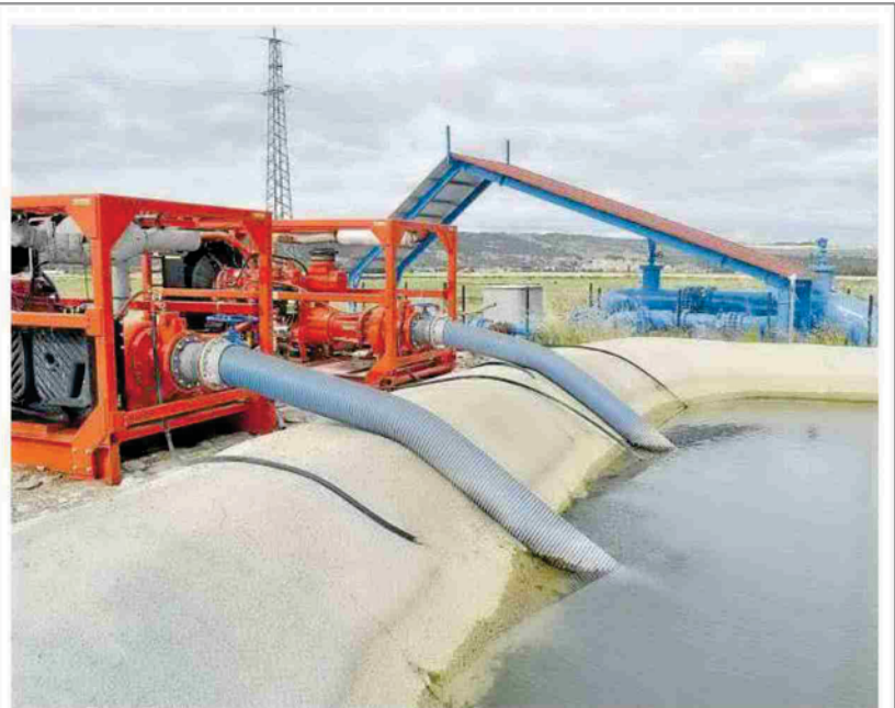
Funes dispuso en 2018 de la instalación de un bombeo provisional para salvar la campaña. Foto: María San Gil
