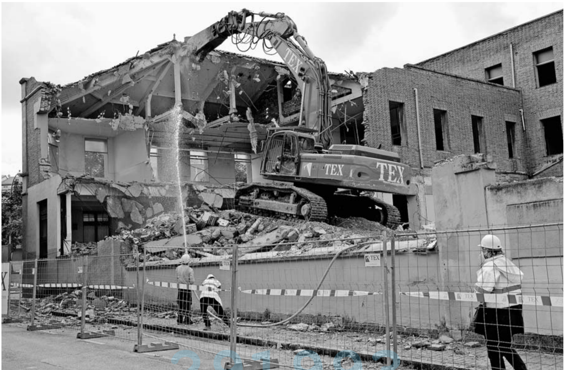
Una máquina en pleno trabajo de demolición del inmueble principal de Salesianos junto a dos operarios encargados de echar agua para evitar polvo en la zona.
