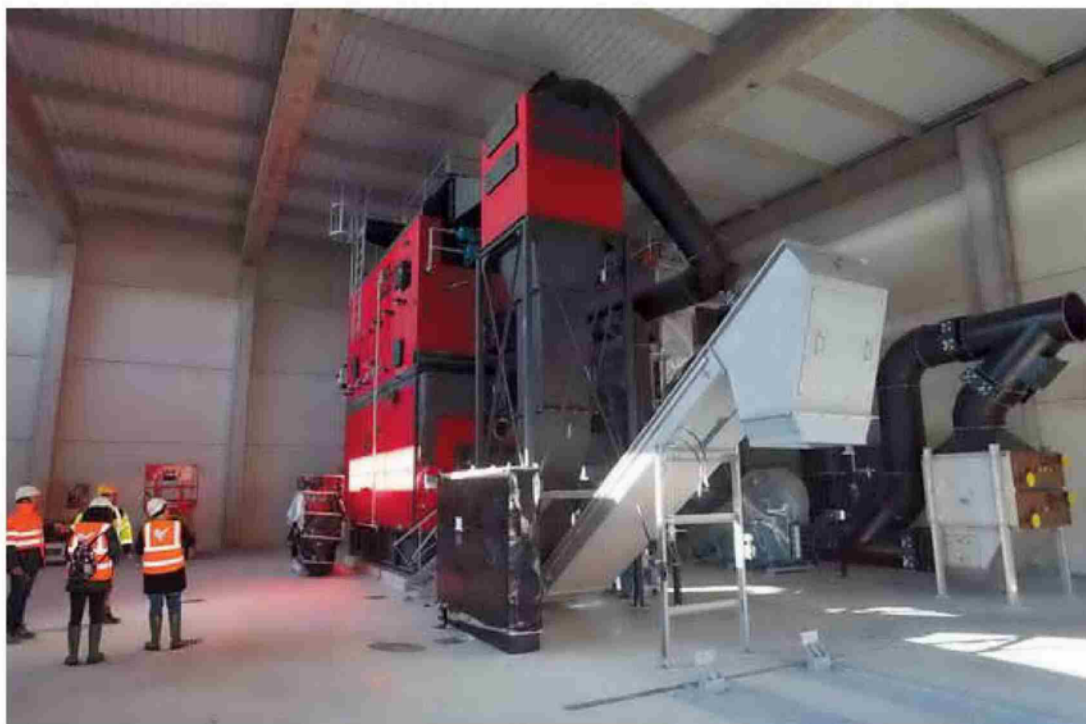
La caldera de biomasa, con sus sistemas de filtrado y recuperación de calor, ya instalada en la nave de Ezcaba. Falta la chimenea. EDUARDO BLIXENS
