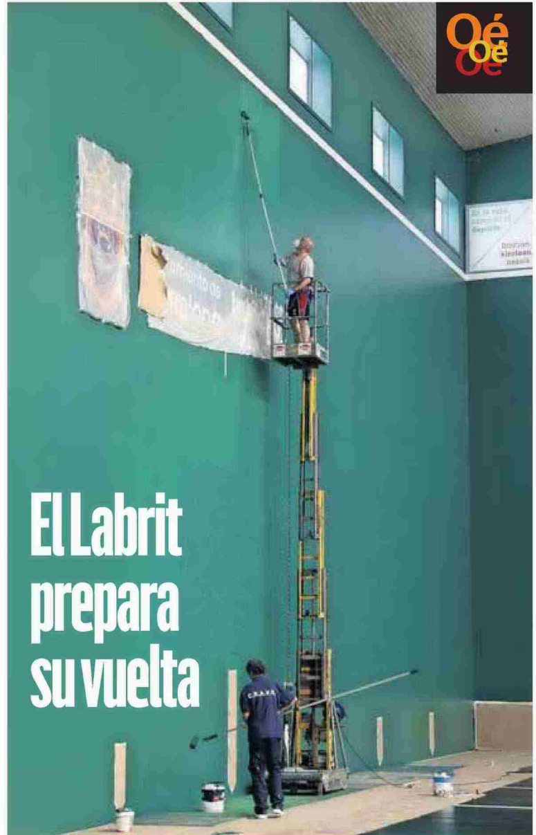
Dos empleados de la Federación Navarra de Pelota trabajan en la pared izquierda del frontón. J. CARLOS CORDOVILLA
