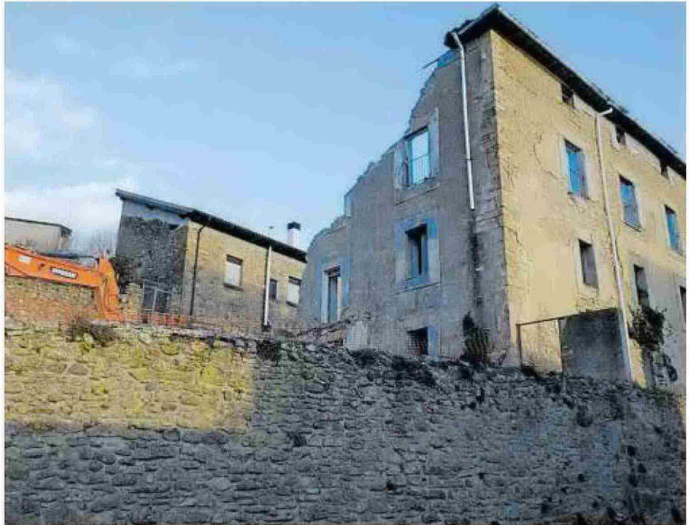
La imagen recoge el inicio de la demolición del edificio el martes por la parte trasera.
