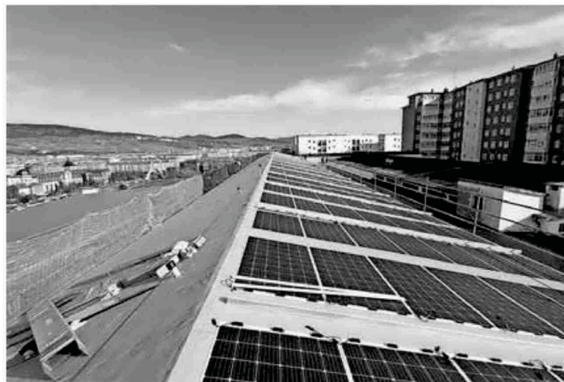
Paneles fotovoltaicos en el tejado de las instalaciones de protección ciudadana en Pamplona.
