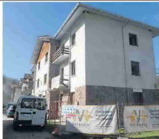
Casas de los Camineros, donde se están llevando a cabo las obras.
